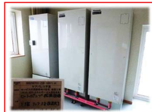
空気熱源ヒートポンプ暖房機
